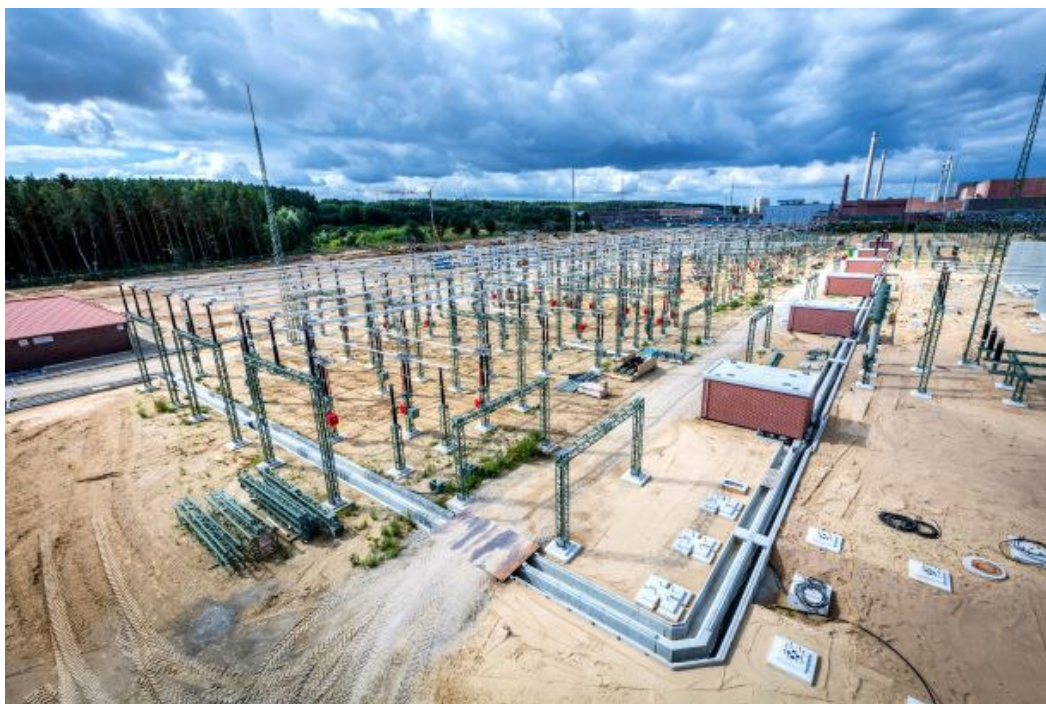
Bild 51: Komplette Erneuerung des 380/220/110-kV-UW Lubmin u. a. für die Anschlüsse der Offshore-Windparks (am rechten oberen Bildrand ist der Bereich des ehem. KKW Lubmin zu sehen)
