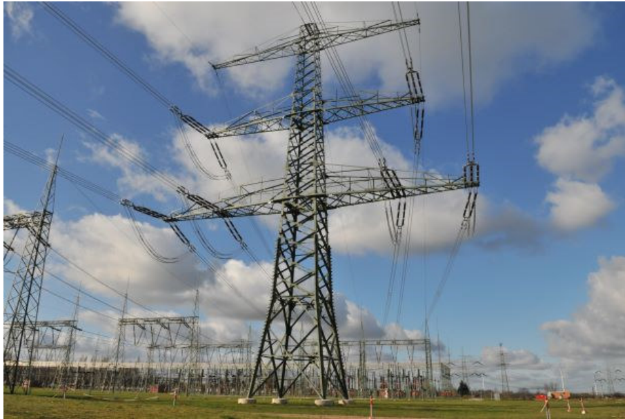
Bild 37: Endmast der 380-kV-Südwest-Kuppelleitung (1. Abschnitt) Lauchstädt - Vieselbach vor dem UW Lauchstädt © VE Transmission
