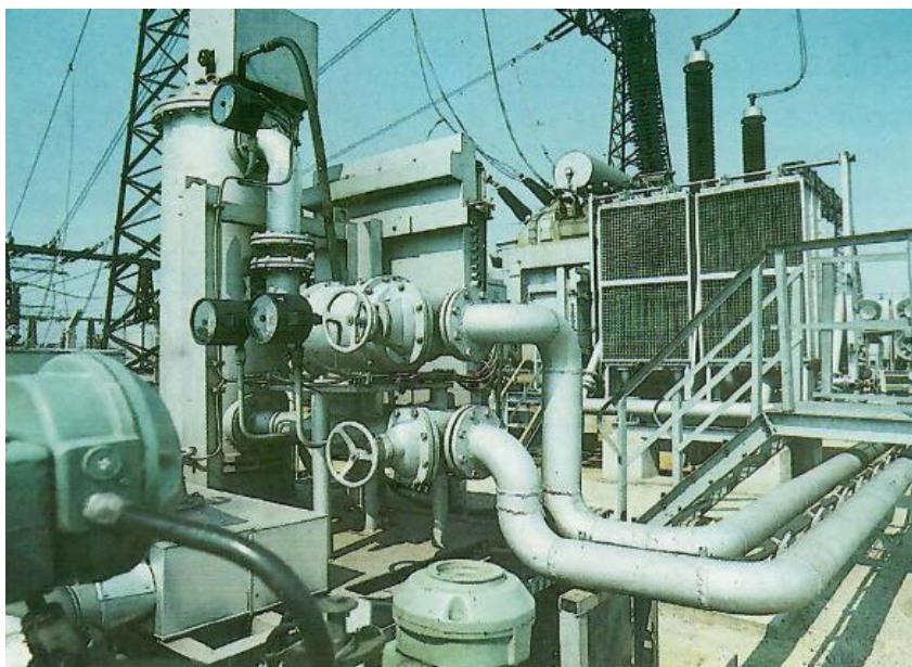
Bild 22: Baustein zur Nutzung der Transformator-Verlustwärme (TVW) Broschüre mit dem Leistungsverzeichnis des VE Kombinat Verbundnetze Energie, undatiert
