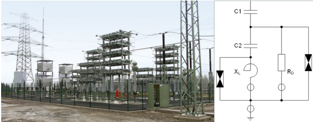
Bild 44: 380-kV-MSCDN 200 Mvar UW Altenfeld (links) und single line (rechts) C – Kondensatorbatterien, X_L – Drosselspule, R_D – Dämpfungswiderstand u. Überspannungsableiter © 50Hertz
