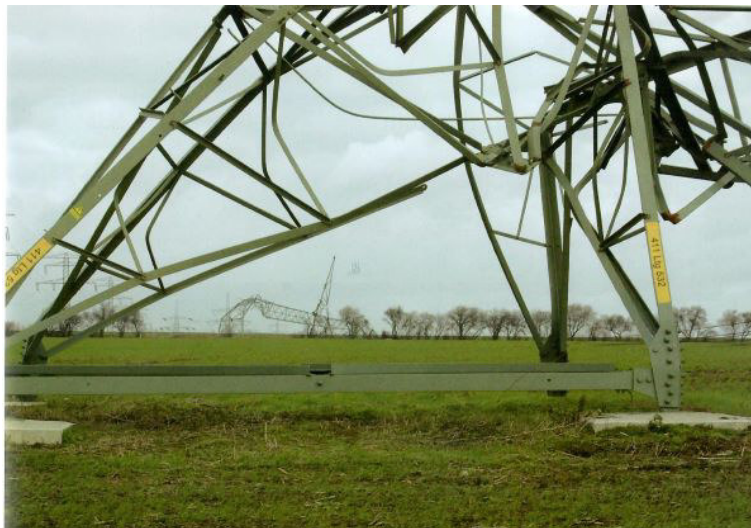
Bild 36: Mastumbrüche auf der 380-kV-Ltg. Ragow – Wolmirstedt durch „Kyrill“ © VE Transmission
