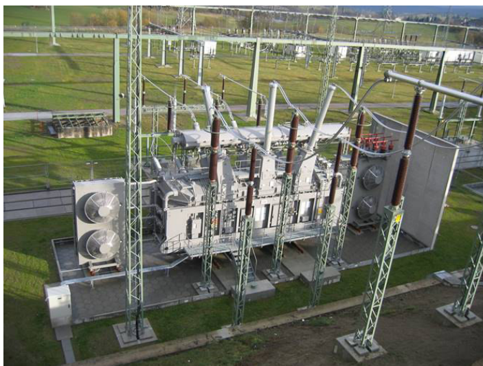
Bild 34: 400-MVA-Transformator 380/220(110) kV im UW Remptendorf © VE Transmission
