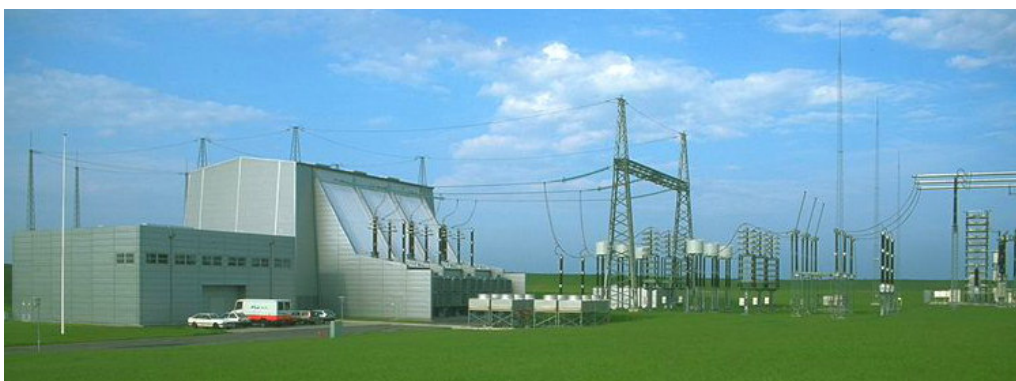
Bild 31: HGÜ KONTEK am Standort UW Bentwisch Konverterhalle mit eingehausten einpoligen Stromrichtertransformatoren (links) und Beginn der 380-kV-AC-Anlage für die Filterkreise und Drosselspule (rechts) © ABB
