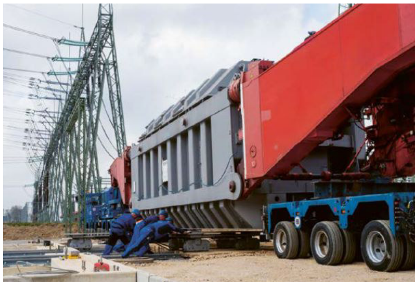
Bild 48: Anlieferung eines PST im UW Röhrsdorf (baugleich im UW Vierraden) © 50Hertz
