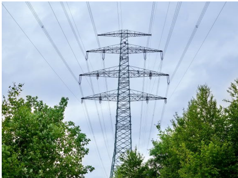
Bild 47: 380-kV-Südwest-Kuppelleitung (inkl. Mitnahme 110 kV) © 50Hertz
