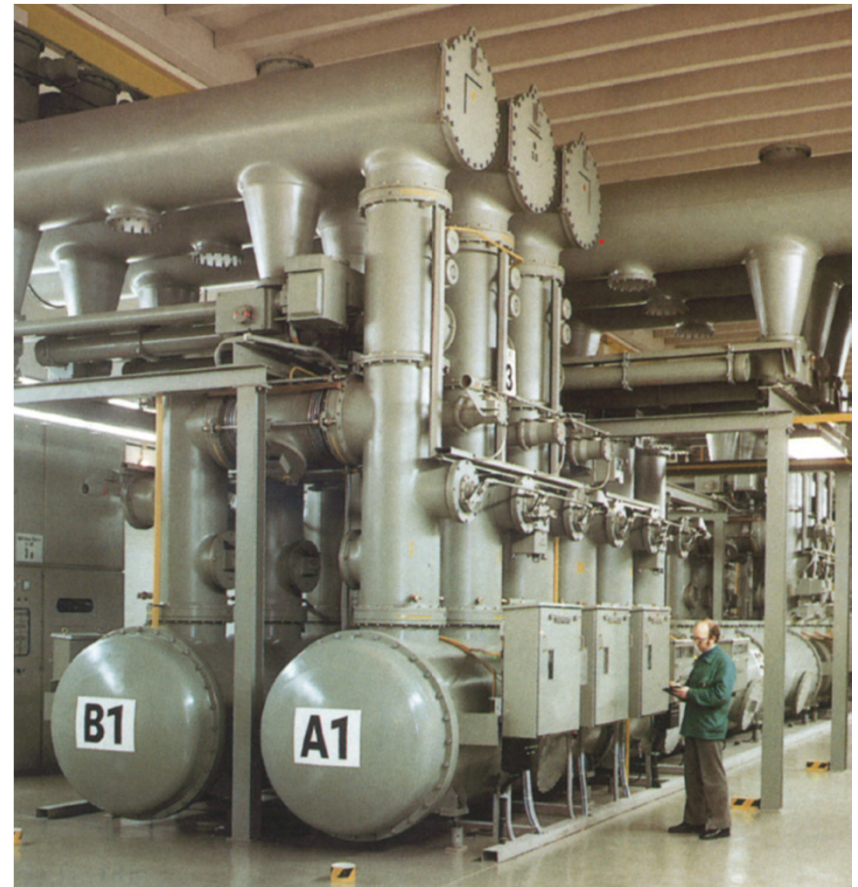
Bild 21: SF 6 -gasisolierte 380-kV-Schaltanlage im UW Reuter
