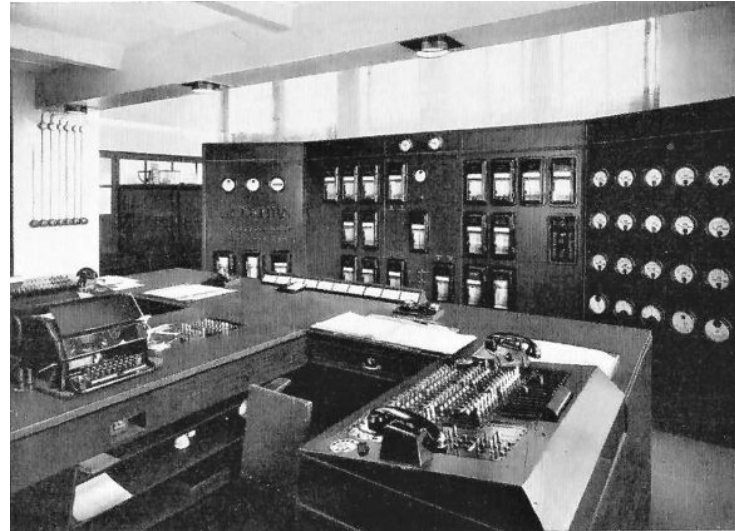
Bild 9: Bewag-Lastverteilerwarte im KW Klingenberg
