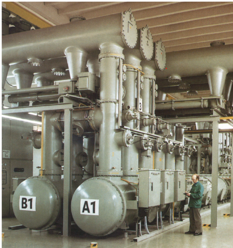
Bild 7: SF 6 -gasisolierte 380-kV-Schaltanlage im UW Reuter © Bewag
